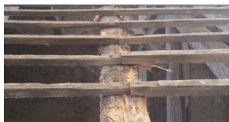
Poškozená krokově šora.
