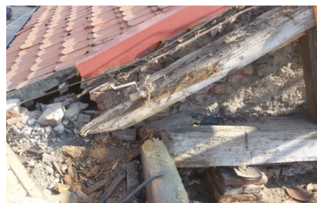
Kompletně odhnilá pata krovu.
