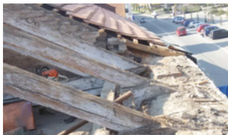
Ujetá pata krovu po odlehčení.
