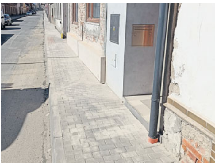
Nový chodník dostala část ulice Sokolovská. Realizace se chopily Služby Města Milevska, které tak pomohly dokončit protahující se realizaci pokládky elektrického vedení společnosti E.ON.
